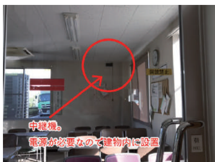
中継機は窓際に設置
