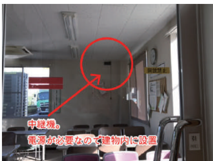
中継機は窓際に設置
