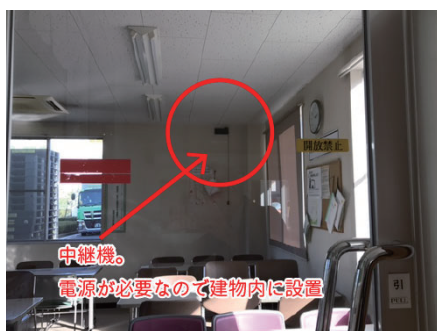
中継機は窓際に設置
